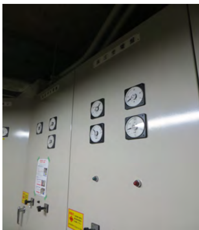
中央図書館 高圧受電盤
