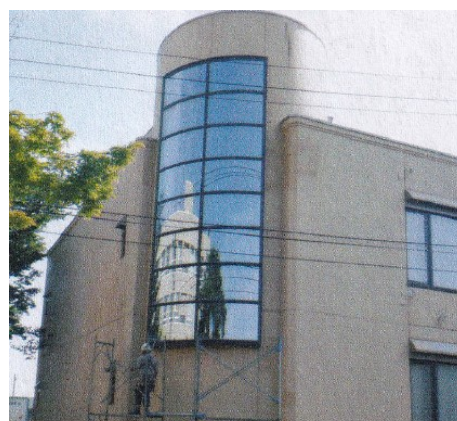
西地域図書館 雨漏り修繕
