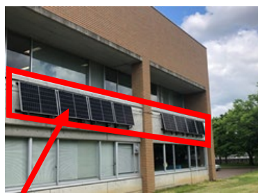
建物壁面に軽量型太陽光パネルを設置しています。
